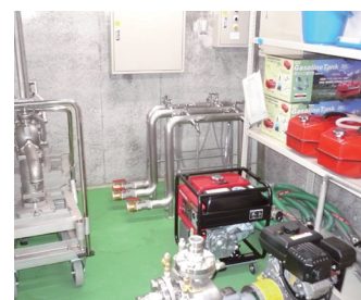
倉庫内配備状況
